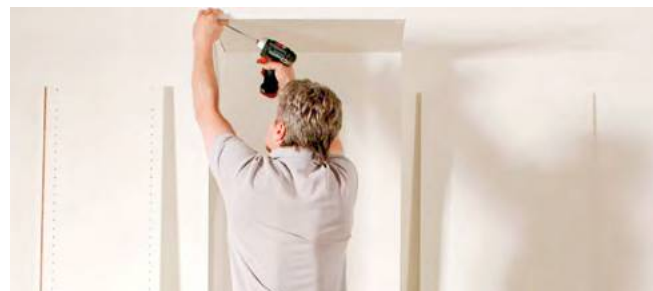
Akkuschrauber bereithalten und vordere Ecke verschrauben. So sind auch Einmannmontagen problemlos möglich.
